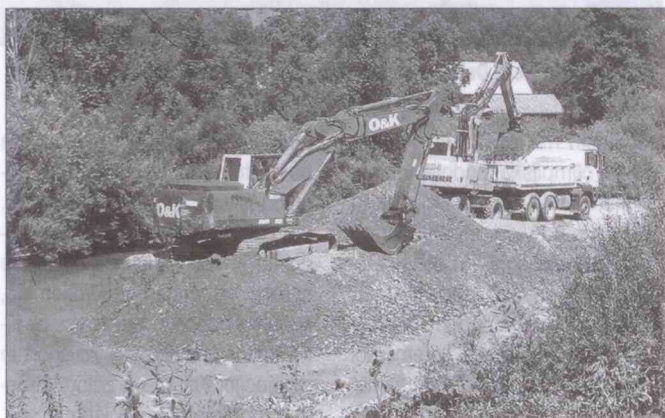
Odstranjevanje naplavljenega proda (Foto: LM)
